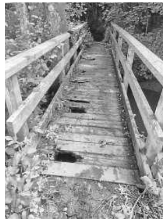
Schaden an der Teufenbachbrücke
